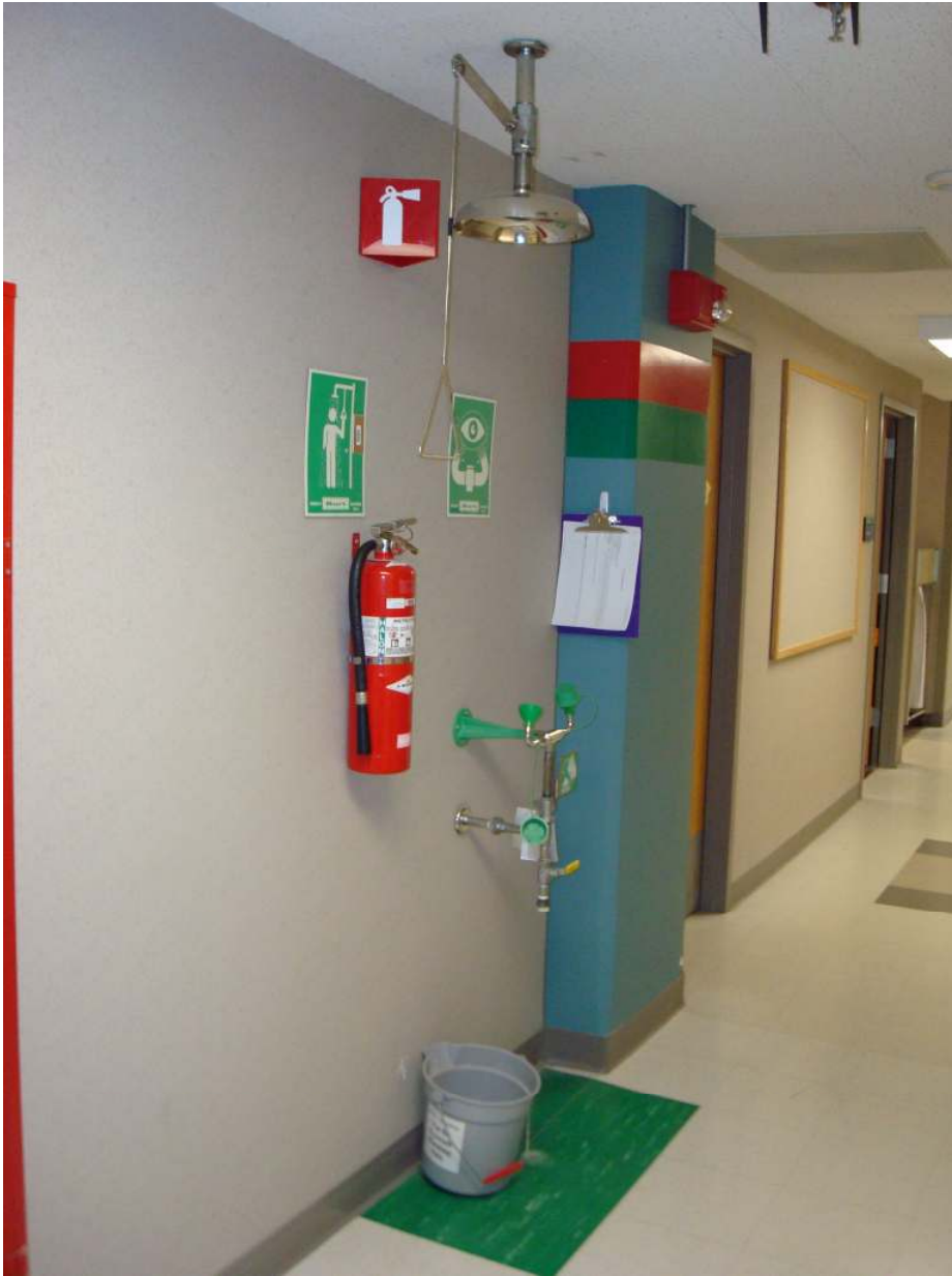
Figür 2: Bir göz yıkama, tüm vücut yıkama ve yangın söndürme istasyonu.
